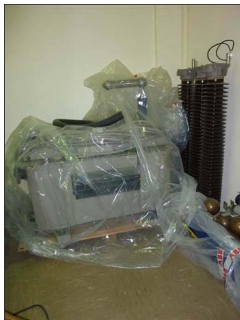
Fig. D Rectificador de 100 kV y aislantes.
