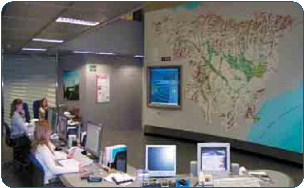
Centro de Control SAIH SAICA
